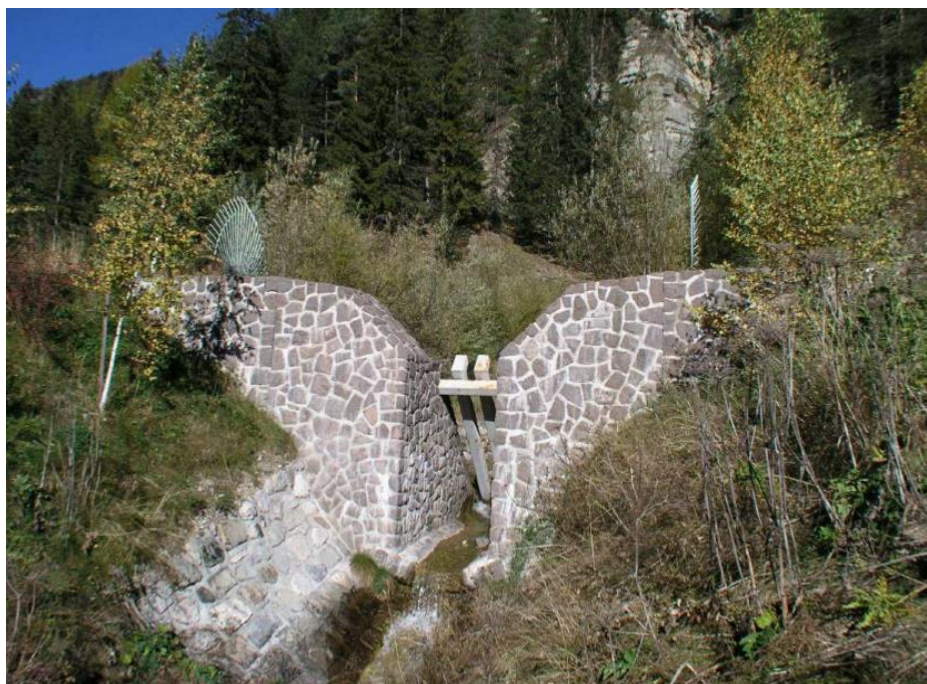
Figura 4.3: briglia filtrante sul rio di Gries.
